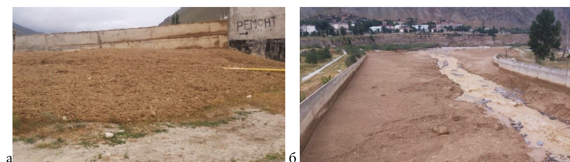
Рис. 5. (а) Линия газопровода, занесенная селевыми отложениями; (б) селевые отложения в устье р. Герхожансу (фото Д. Р. Джаппуева 25 июля 2025 г.) Fig. 5. (a) Gas pipeline section covered by mudflow deposits; (b) mudflow deposits at the mouth of the Gerkhozhansu River (photo by D. R. Dzhapsuev, July 25, 2025)
