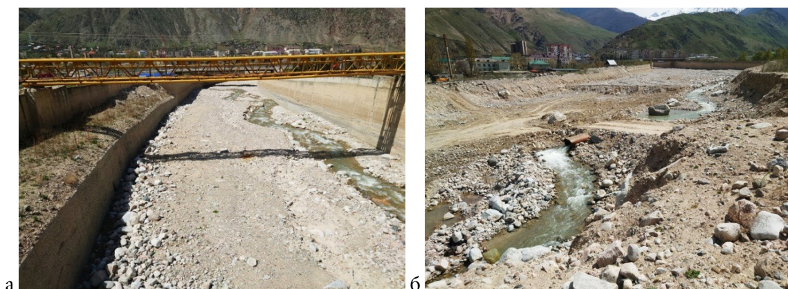
Рис. 4. Состояние селевого русла 1 мая 2025 г. (с действующей газопроводной трубой) «до» схода селя 21.07.25 (фото М. Т. Юанова)
