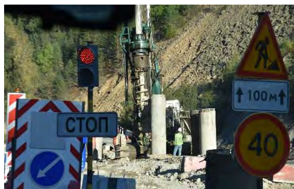
Рис. 4. Ремонт автодороги Прохладный – Азау в районе п. Нейтрино (последствия схода катастрофического селя по р. Адьлсу в 2017 г.) (справа). Фото Е. В. Кюль. Июнь 2022 года.
